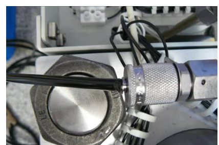
Tuyau de purge
